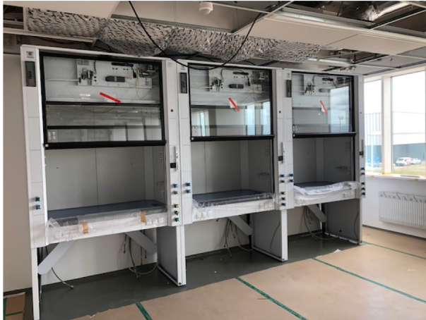
D08 fume hoods
