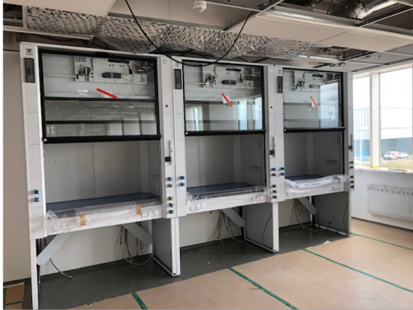
D08 fume hoods
