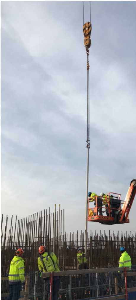
Electrical conduits (April 17)
